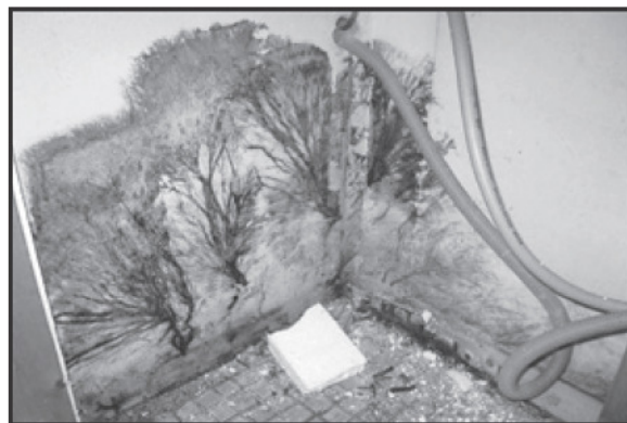
Abb. 6: Coniophora spec. Befall in der Ständerkonstruktion eines Holzrahmenbaus (sichtbar nach Rückbau Trockenbau)
