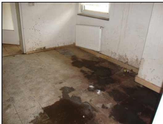
Abb. 9: Ölkontaminierter Schlamm im Fußbodenbereich
