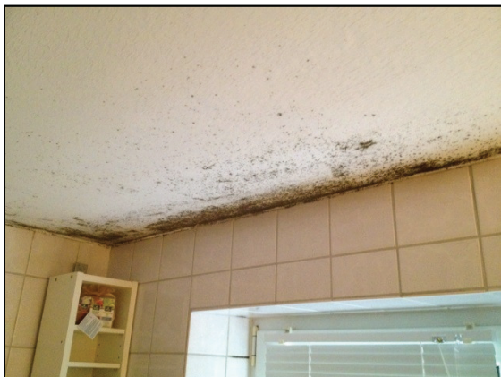
Abb. 4: Schimmelpilzbefall unter der Decke oberhalb der Fenster im Bad
