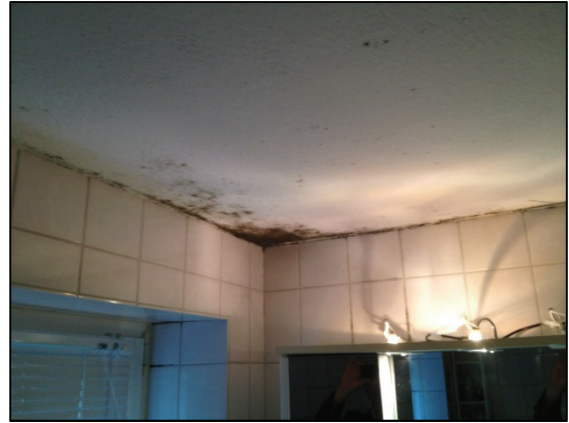
Abb. 5: Schimmel an der Badezimmerdecke in den Ecken
