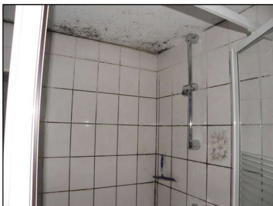
Abb. 8: Schimmelflecken oberhalb der Dusche
