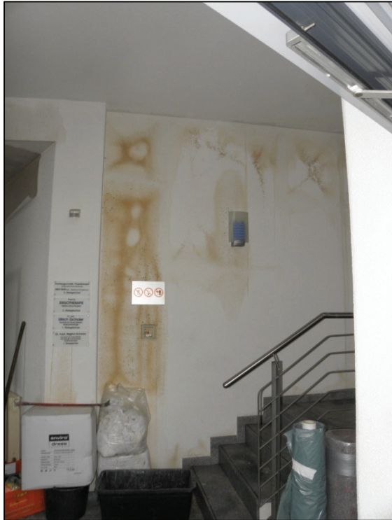
Abb. 16: Wasserschaden im Erdgeschoss als Folge der Löscharbeiten
