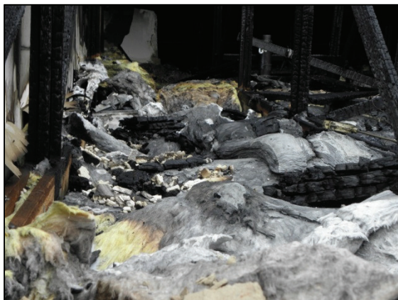
Abb. 17: Mineralwollaufflage verhindert Feuerüberschlag auf Nachbarpraxis
