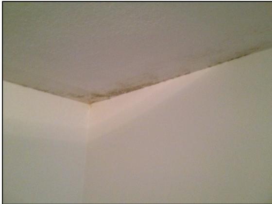
Abb. 2: Schimmelflecken an geometrischer Wärmebrücke
