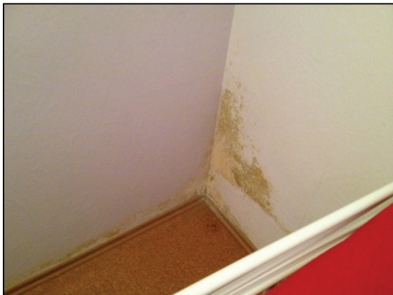
Abb. 3: Schimmelspuren in den Ecken
