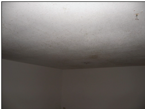
Abb. 7: Zweite Ortsbesichtigung – Schimmelflecken an der gesamten Decke
