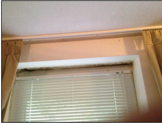
Abb. 1: Schimmel am Fenstersturz – Kippstellung Fenster
