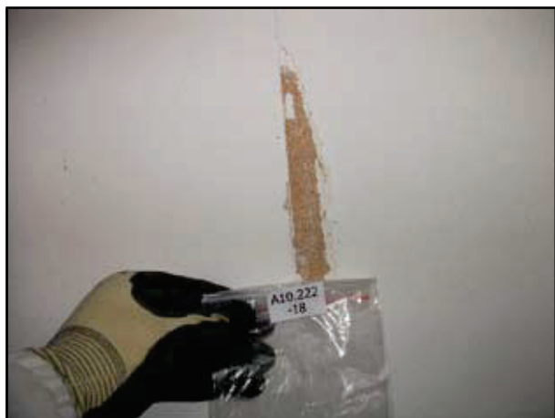
Abb. 12: Fugenfüller und Spachtelungen auf Spanplattenwänden
