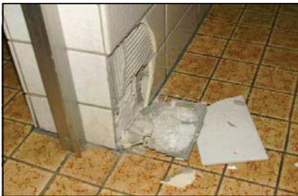
Abb. 15: ... und sehr weit verbreitet, asbesthaltige Fliesenkleber
