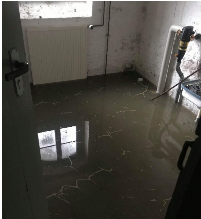
Abb. 1: Eine Belastung der Estrichdämmschicht mit Fäkalien kann durch den Nachweis von Indikatorbakterien festgestellt werden (Quelle: Blei-Institut)
