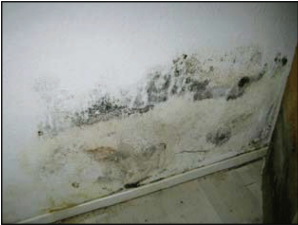
Abb. 5: Mit Schimmelpilzen befallener Putz (Quelle: Sprint Sanierung GmbH)
