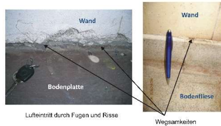
(1) Eintrittswege für Radon durch Risse und Spalten
